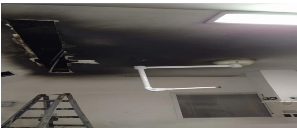
Techo, luego del incendio.
