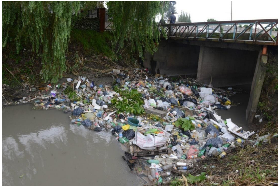
Foto 14 : Residuos obstruyendo el cauce natural del arroyo en la estación de muestreo 421. Foto: Fernando Calzada.
