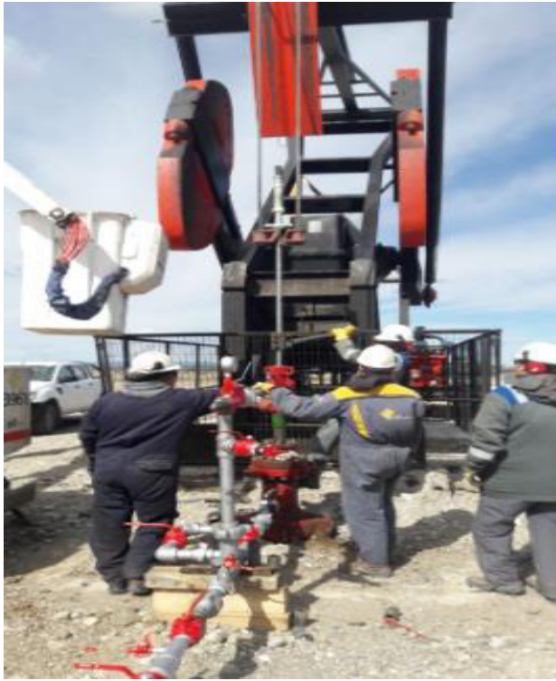
Foto 3. Cuadrilla poniendo en marcha equipo de BM.
