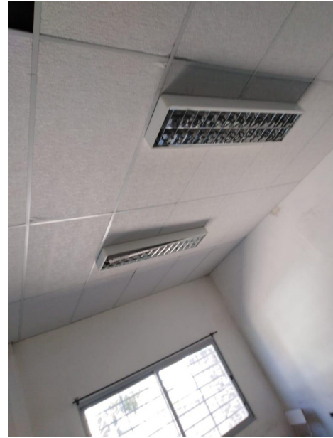
Imagen 3: Vista luminaria y cielo raso.
