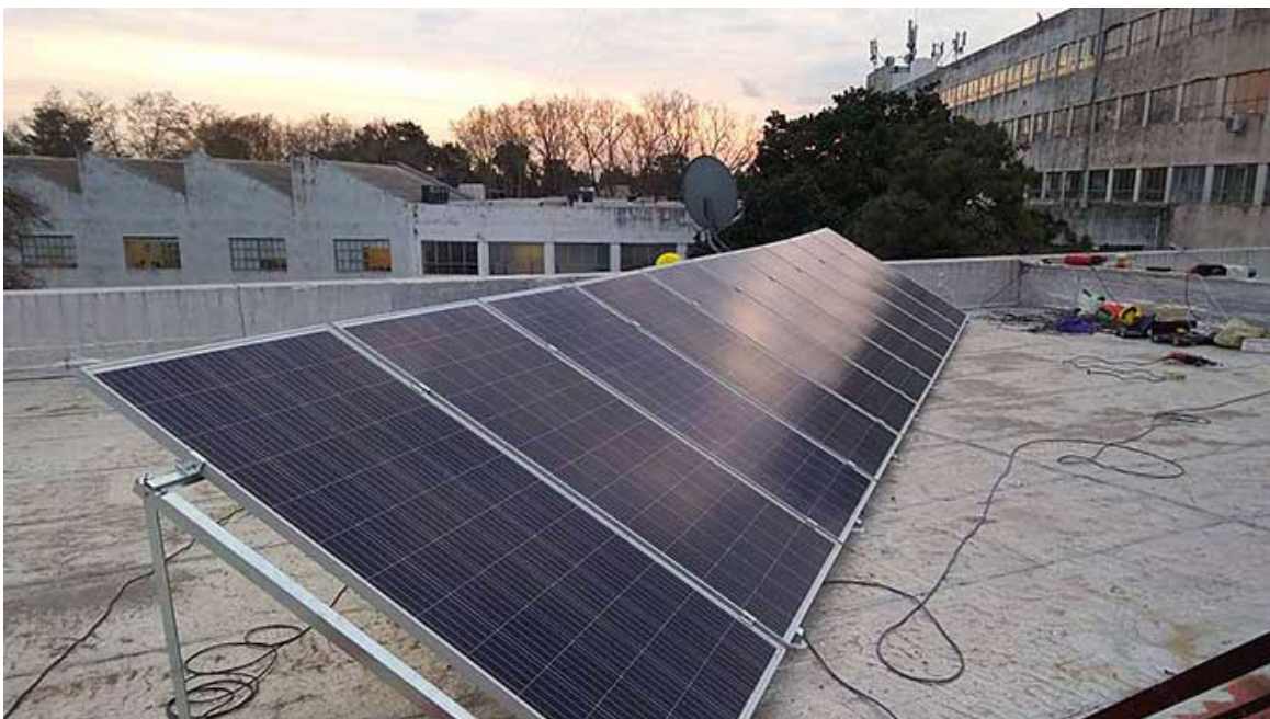
Imagen 2: Paneles Fotovoltaicos instalados en el techo del edificio Mosconi.
